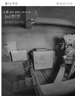
传染楼机房-B版摄像头 宁医大总院
